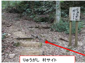
りゅうがし 村サイト 階段土止めが崩れている 修理
